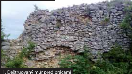
1. Deštruovaný múr pred prácami
